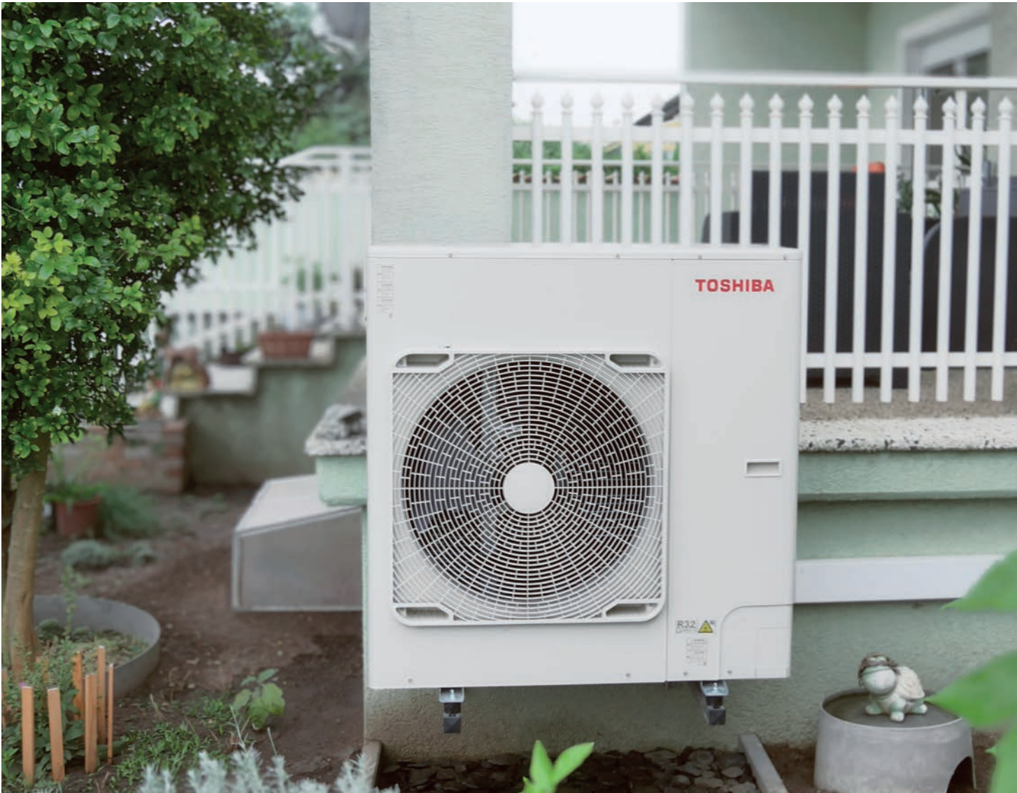
Enodružinska hiša Podersdorf, Robert Müllner GmbH - Kälte Klima Installateur
